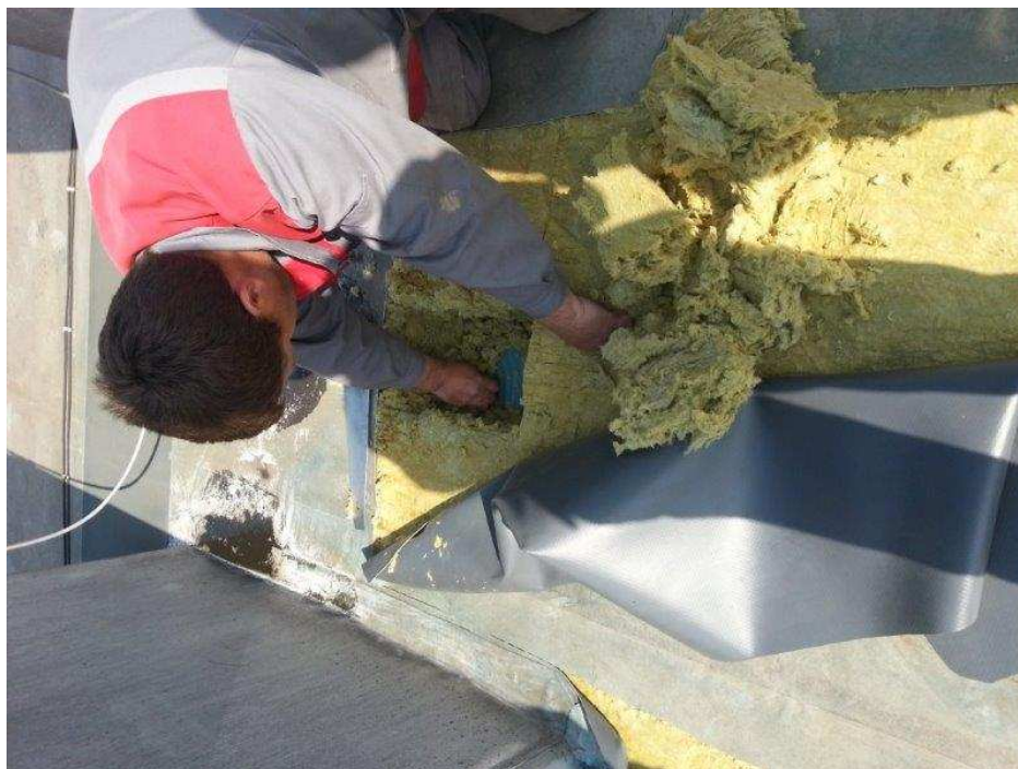
Slika 9: streha objekt F3, Zelena Jama, izrez folije, pogled na obstoječo namočeno toplotno izolacijo
