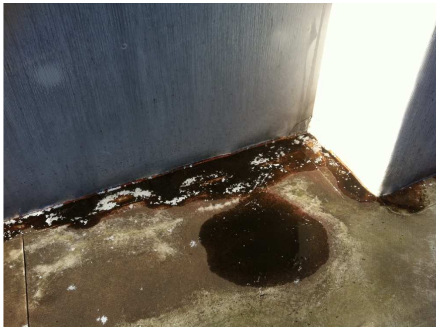
Slika 14: streha objekt F3, Zelena Jama – detajl dimnika zastajanje vode okrog dimnikov, manjkajoči del folije zaključka na vogalu
