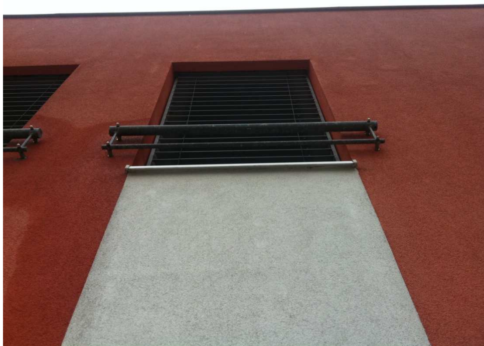
Slika 28: terasa, objekt F3, Zelena Jama – vidno zamakanje ob dežju, zaključna pločevina na strehi ima samo 2cm odkapa, zato prihaja do močenja fasade ob dežju, v stanovanju 21, v 6. nadstropju, vhod 58A; BEČIĆ DEDIĆ
