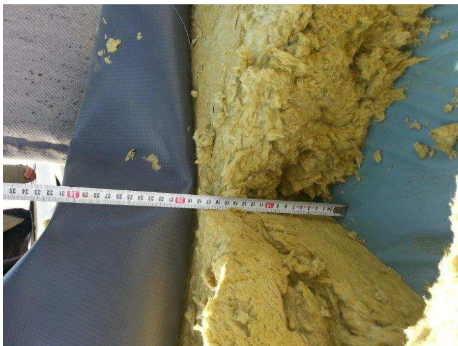
Slika 10: streha objekt F3, Zelena Jama, pogled na obstoječo namočeno toplotno izolacijo, debelina 12cm
