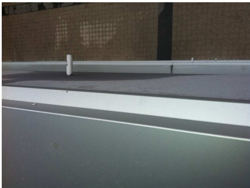
Slika 30: terasa, objekt F3, Zelena Jama – varnostni preliv, v stanovanju 21, v 6. nadstropju, vhod 58A; BEČIĆ DEDIĆ
