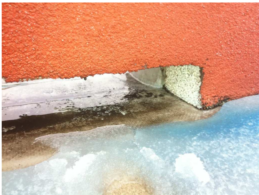
Slika 24: streha, objekt F3, Zelena Jama – detajl preliva s strehe lože na glavno streho, nepravilni zaključek fasade v notranjosti preliva
