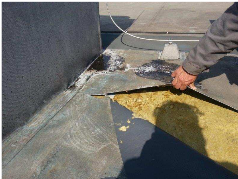
Slika 6: streha objekt F3, Zelena Jama, izrez folije na osi 5, pogled na obstoječo namočeno toplotno izolacijo
