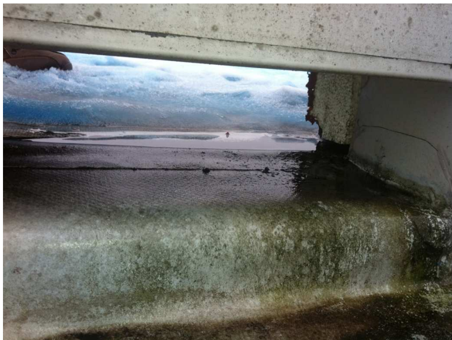
Slika 23: streha, objekt F3, Zelena Jama – detajl preliva s strehe lože na glavno streho, nepravilni zaključek zaključne PE folije v notranjosti preliva
