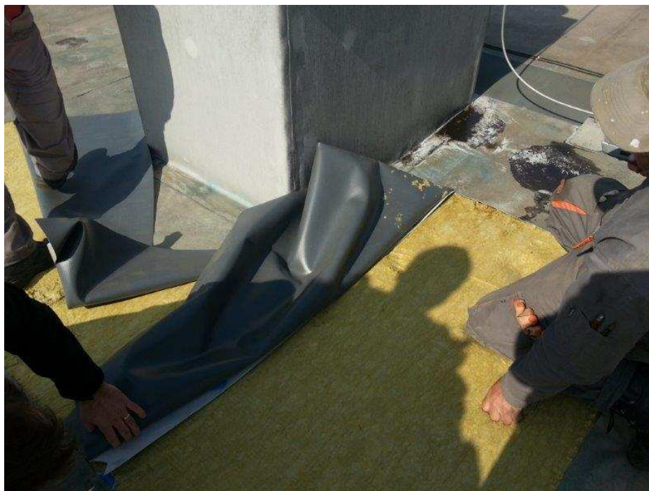
Slika 7: streha objekt F3, Zelena Jama, izrez folije, pogled na obstoječo namočeno toplotno izolacijo
