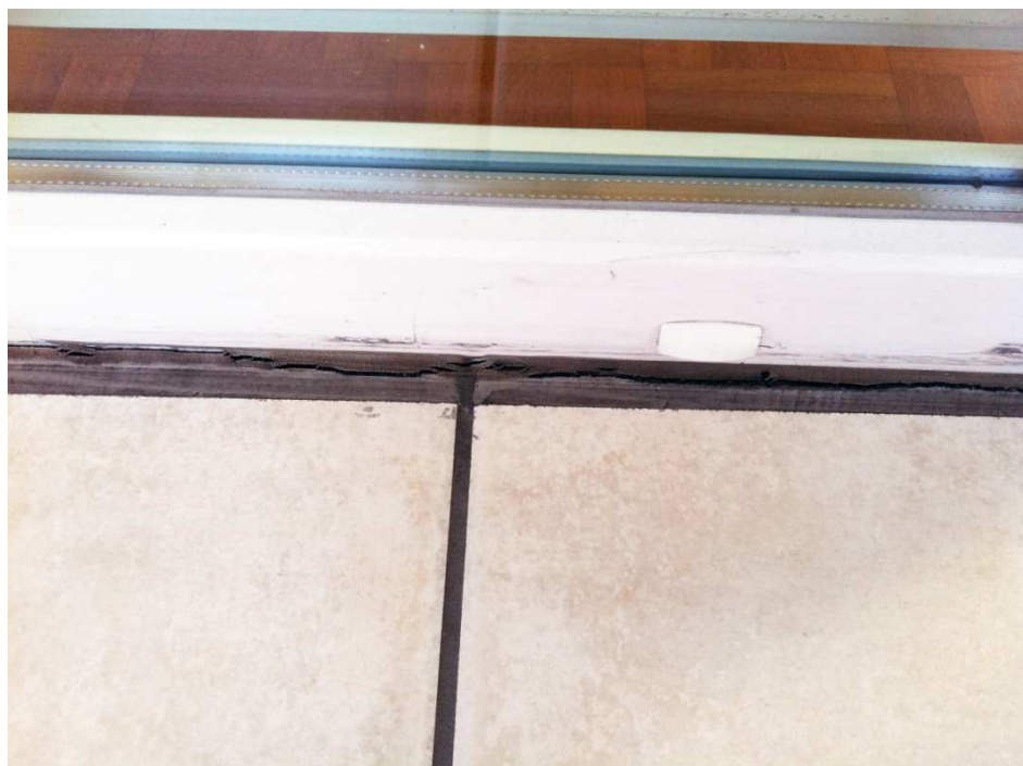
Slika 32: terasa, objekt F3, Zelena Jama – trajnoelastični kit pri balkonskih vratih je popokan-možnost zamakanja v konstrukcijo, v stanovanju 21, v 6. nadstropju, vhod 58A; BEČIĆ DEDIĆ
