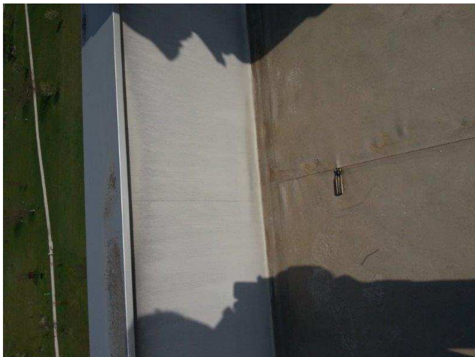
Slika 3: streha objekt F3, Zelena Jama, nepravilna vgradnja folije Sikaplan, netesnitev
