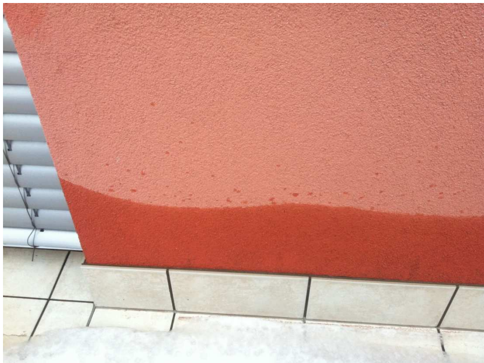
Slika 27: terasa, objekt F3, Zelena Jama – vidno zamakanje ob dežju, obstenska keramika ni zaščiten s trajnoelastičnim kitom, možnost zamakanja v konstrukcijo, v stanovanju 21, v 6. nadstropju, vhod 58A; BEČIĆ DEDIĆ
