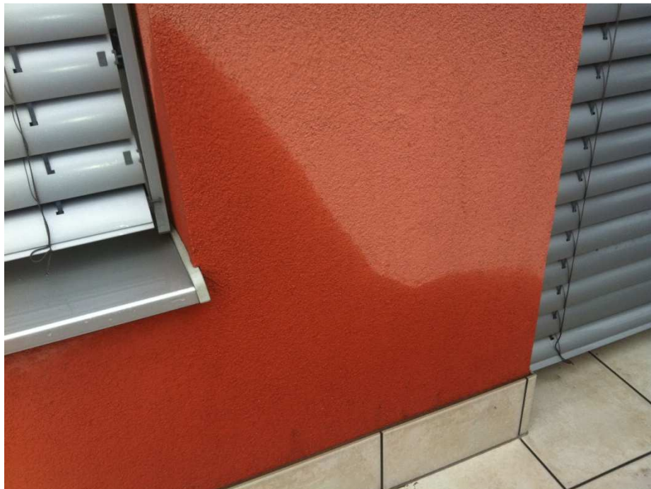
Slika 26: terasa, objekt F3, Zelena Jama – vidno zamakanje ob dežju, obstenska keramika ni zaščiten s trajnoelastičnim kitom, možnost zamakanja v konstrukcijo, v stanovanju 21, v 6. nadstropju, vhod 58A; BEČIĆ DEDIĆ
