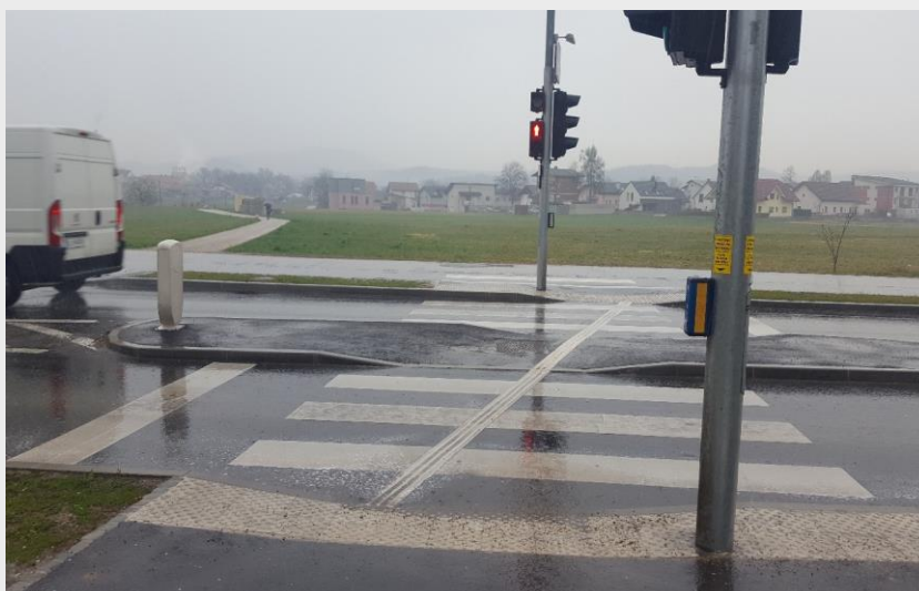
Slika 68 (neustrezno): Primer taktilne reliefne črte čez zebro, ki ni usklajena z lokacijami semaforjev. Taktilne vodilne linije morajo povezovati zvočne semaforje in so lahko največ 60 cm oddaljene od teh, da so uporabne.
