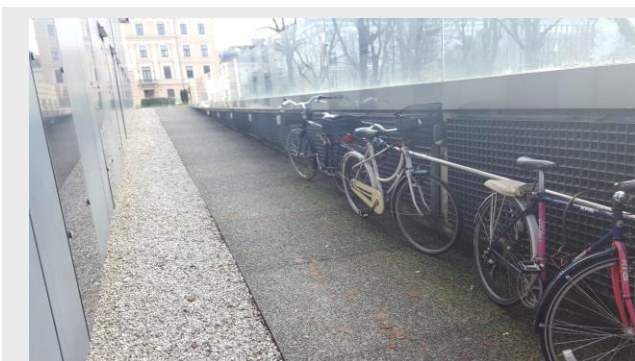
Slika 35 (neustrezno): Pomanjkljivo načrtovana klančina. Klančina, namenjena dostopu z vozičkom do vhoda v objekt, ima oprijemalo načrtovano samo ob spodnjem delu na eni strani. Ker ob objektu ni načrtovanih parkirišč za kolesa, kolesarji uporabljajo oprijemalo za parkiranje koles.
