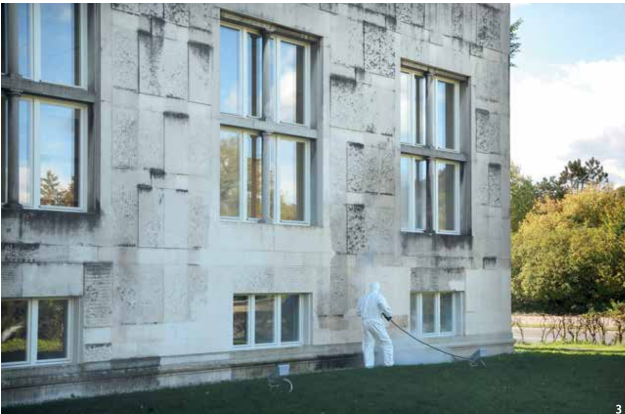
3 Čiščenje fasade z visokotlačnim parnim čistilnikom leta 2009 (foto: M. Režek Kambič, ZVKDS OE Ljubljana). Cleaning the facade using a high-pressure steam cleaner, 2009 (photo: M. Režek Kambič, ZVKDS OE Ljubljana).
