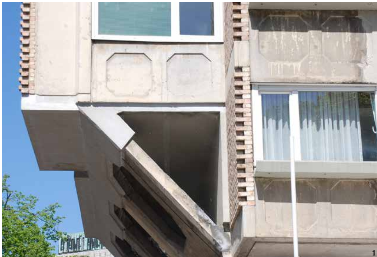
1 Degradacija izvorne arhitekturne prvine na bloku A v Ferantovem vrtu (foto: T. Adamič). Decaying original architectural element on Building A at the Ferant Garden housing development (photo: T. Adamič).
