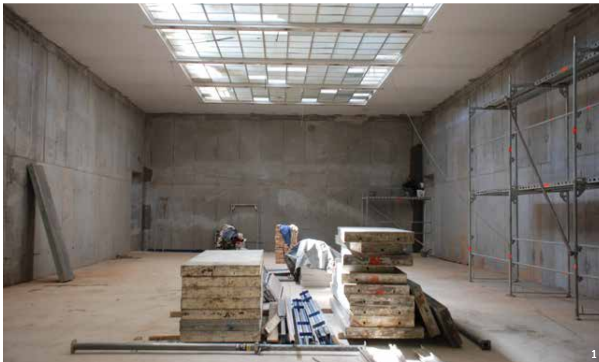
1 Obbetonirane stene dvorane leta 2006 (foto: M. Režek Kambič, ZVKDS OE Ljubljana). Cladding the interior walls in precast concrete panels, 2006 (photo: M. Režek Kambič, ZVKDS OE Ljubljana).
